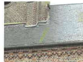
73 - Colonisation du versant Nord de la nef par les algues
