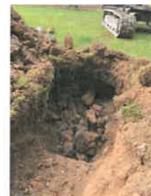
Figure 28 : Fosse de sondage n°3 (éboulement)
