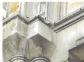
60 - Lacune sur le bandeau du portail en élévation Est de l'église
