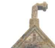
44 - Détail de la croix lacunaire, en porte-à-faux
