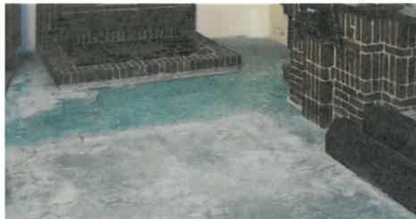
55 - Aperçu du sol du bras Sud du transept avant la reféction en carrelage Cérame, illustrant les efflorescences sur un sol apparemment en béton peint ou teinté dans la masse Inventaire général des Hauts-de-France - cote IVR22_20068000311A - n.d.
