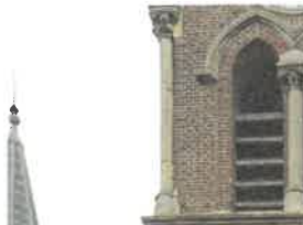
45 - Colonnette fracturée à l'angle Sud-Est du clocher
