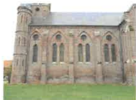
66 - Efflorescences généralisées en partie basse de l'élévation Nord de la nef
