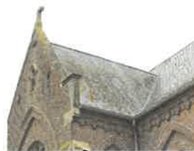
74 - Lichens sur la couverture du croisillon Sud
