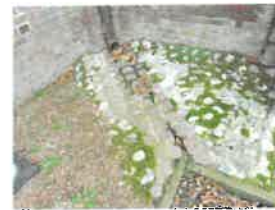
48 - Vue d'ensemble du caniveau à ciel ouvert à l'angle de la nef et du croisillon Nord - joints lacunaires et colonisation par les mousses et herbacés
