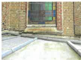
58 - Lacune sur l'appui en pierre de la baie en élévation Nord du chevet
