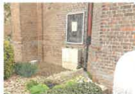
23 - Coffret électrique en élévation Sud de l'avant-nef
