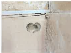
54 - Détail d'un sondage sur le soubassement : complexe plaque de plâtre/polystyrène de type TH32
