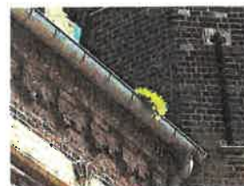
47 - Colonisation végétale de la gouttière de l'élévation Sud de la nef photographie extraite du rapport ARCALIA p. 5
