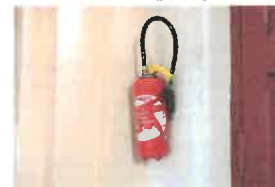
30 - Extincteur à côté de la porte d'entrée
