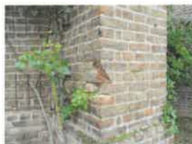
64 - Lacune de parement de brique, probablement causé par un choc, en partie basse du contrefort entre le pan Sud-Ouest du chevet et l'élévation Sud du choeur
