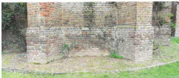
92 - Cumul d'altérations en partie inférieure du pan axial du chevet : efflorescences, colonisation végétale (mousses et lichens), réparations inappropriées et inesthétiques (joints au ciment, reprises modernes en briques), actions anthropiques (installation en pied de rosiers et fixations dans les murs), etc.
