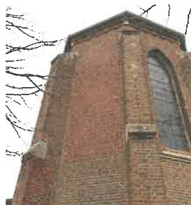
83 - Emploi d'une brique moderne pour le comblement de la baie en pan oisif du chevet
