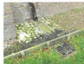
49 - Absence de liaison entre le caniveau et le regard à grille : la bordure empêche l'écoulement des eaux pluviales qui stagnent dans le revers de briques pilées
