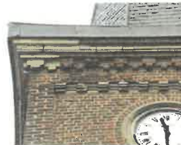
63 - Lacune de briques de la corniche du clocher en élévation Est
