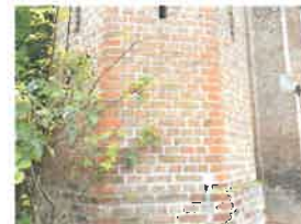
70 - Erosion des briques aux angles de la partie inférieure de la tourelle d'escalier Nord de l'église
