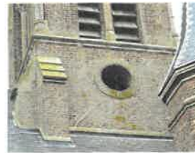
75 - Encroûtement lichénique au Sud du clocher
