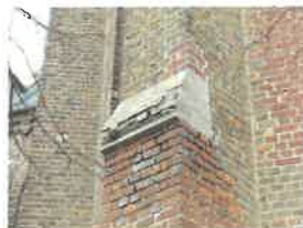
62 - Lacune du ressaut (en béton de ciment ?) et vidage des joints de parement du contrefort entre le pan Nord-Ouest et le pan axial du chevet
