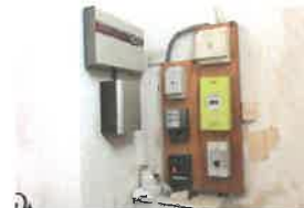
24 - Compteur, coupure générale et centrale de gestion des cloches (à gauche) dans le baptistère
