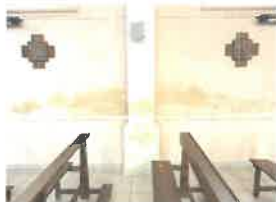
67 - Efflorescences de sels sur les parties basses de l'élévation Nord
