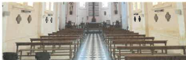
57 - Aperçu actuel du sol de la nef renoué en carrelage Cérame. Les efflorescences en élévation s'expriment sur une aire plus importante.
