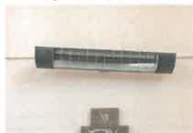
29 - Chauffage électrique radiant dans la nef
